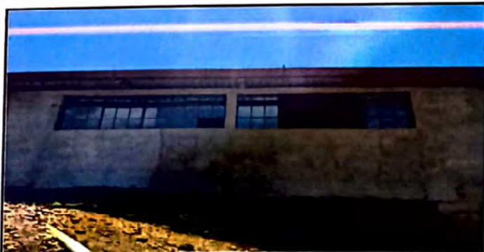
Foto 17: ventanales y vidrio de aula modificado por el fondo de mantenimiento.
